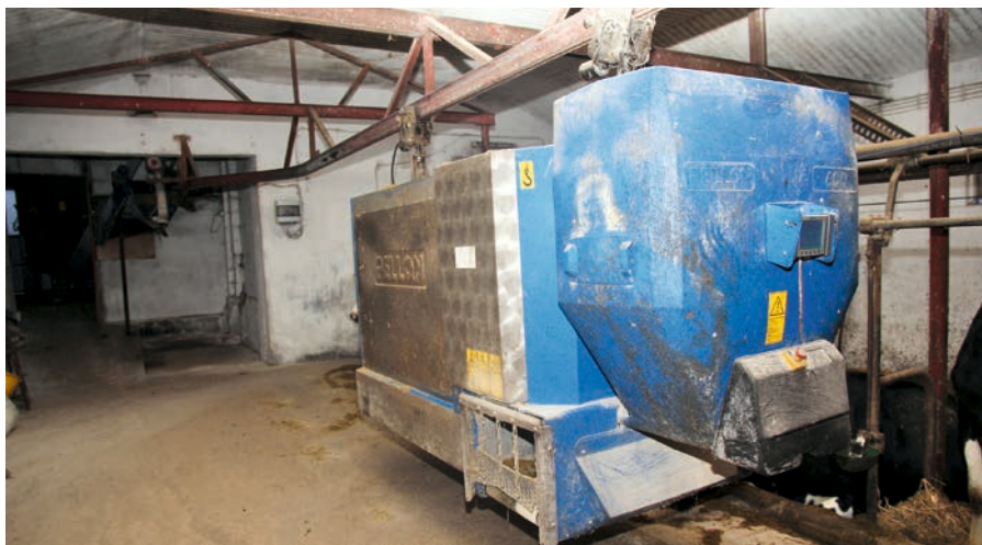
Samojezdny wózek porusza się wzdłuż stołu paszowego po podwieszanej pod sufitem szynie. Jest ona zamontowana do specjalnej stalowej konstrukcji nośnej.
